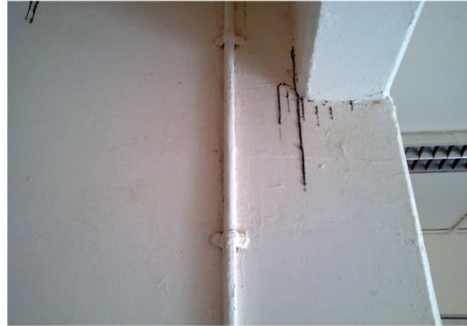
شكل (٦-٢): يوضح تسرب الزيت في بناية قسم الهندسة المدنية.
