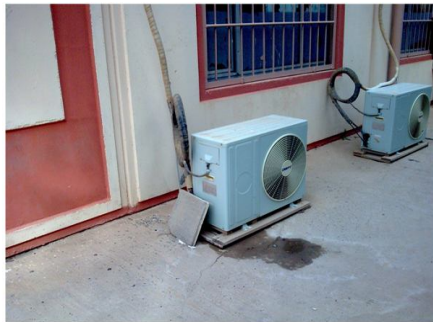
شكل (٦-٣-أ): يوضح الخدمات الكهربائية الظاهرة في بناية قسم الهندسة المدنية.
